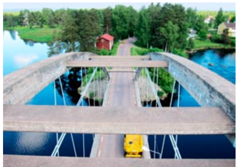
Bessarbrons brobåge har fått sprickorna tätade.
